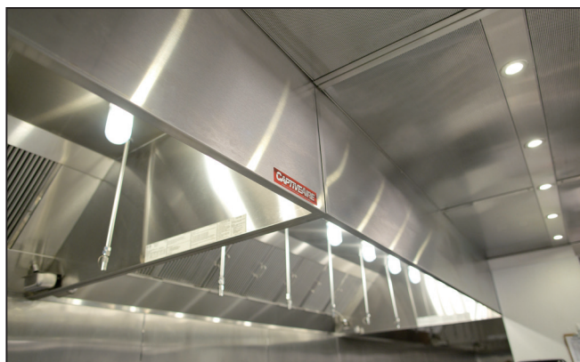
写真2 排気フードシステムの一部
