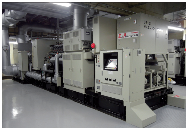
写真4 東京工科大学で稼働する2000kW規模（700 kW × 3台）のコージエネ装置
